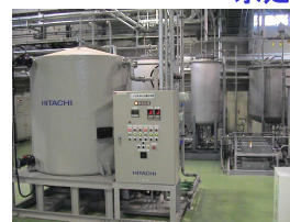
上水貯蔵輸送設備
