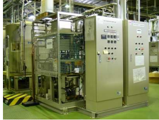
廃棄物燃焼処理装置
