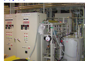
肥料排水処理装置 (逆浸透膜)
